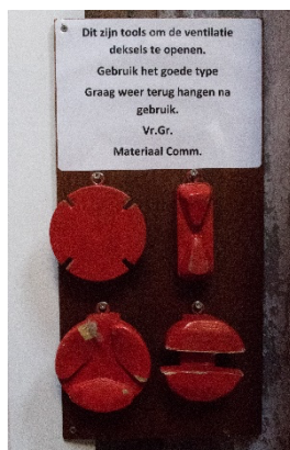
Hulpstukken voor het losdraaien van de luikjes in de luchtkasten
